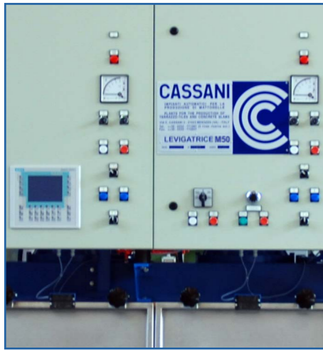
Control panel on board. Panel de control eléctrico
